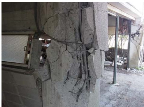
破壊されたホテル1階ピロティ部分のコンクリート
